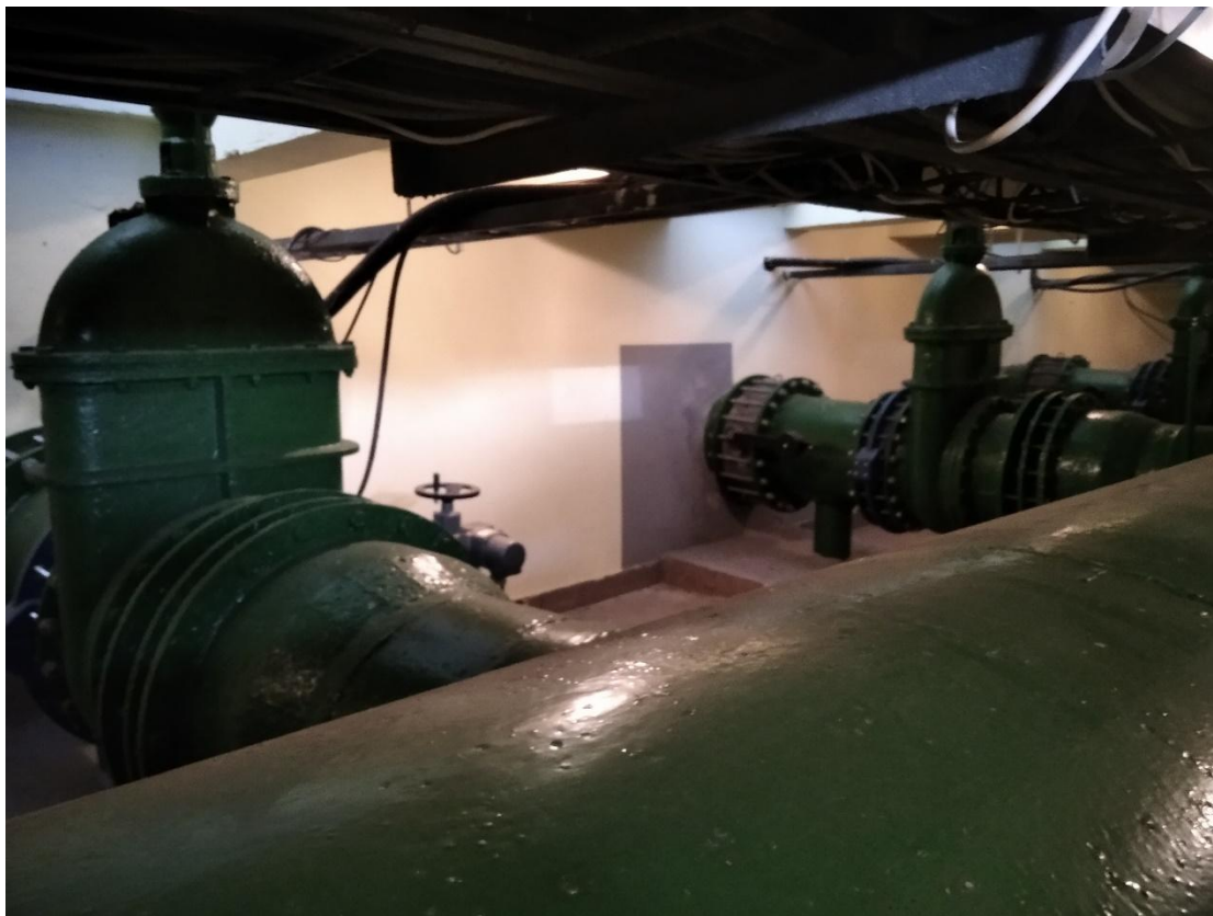
Poziom „-1” pompowni – strona tłoczna pomp
