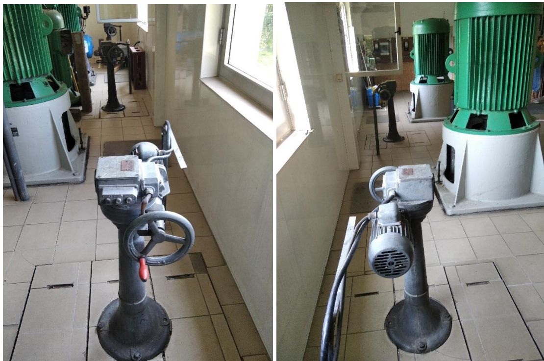
Poziom „0” pompowni – Kolumnienki armatury po stronie ssawnej pomp.
