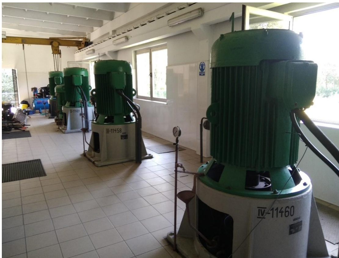
Poziom „0” pompowni – pompy
