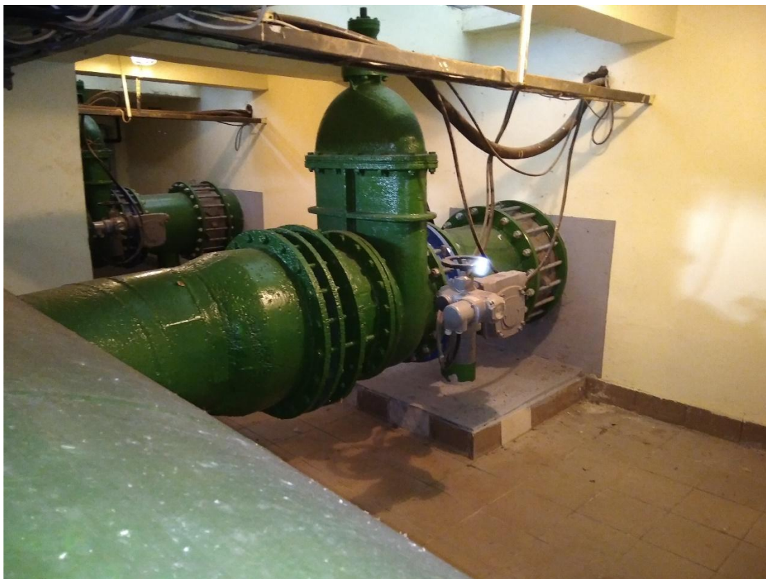
Poziom „-1” pompowni – strona tłoczna pomp
