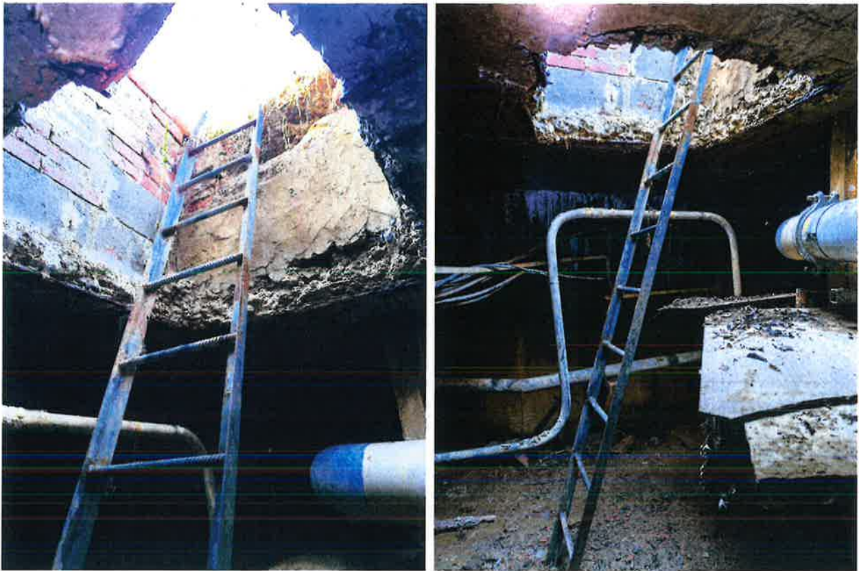
Wejście do kanału technologicznego
