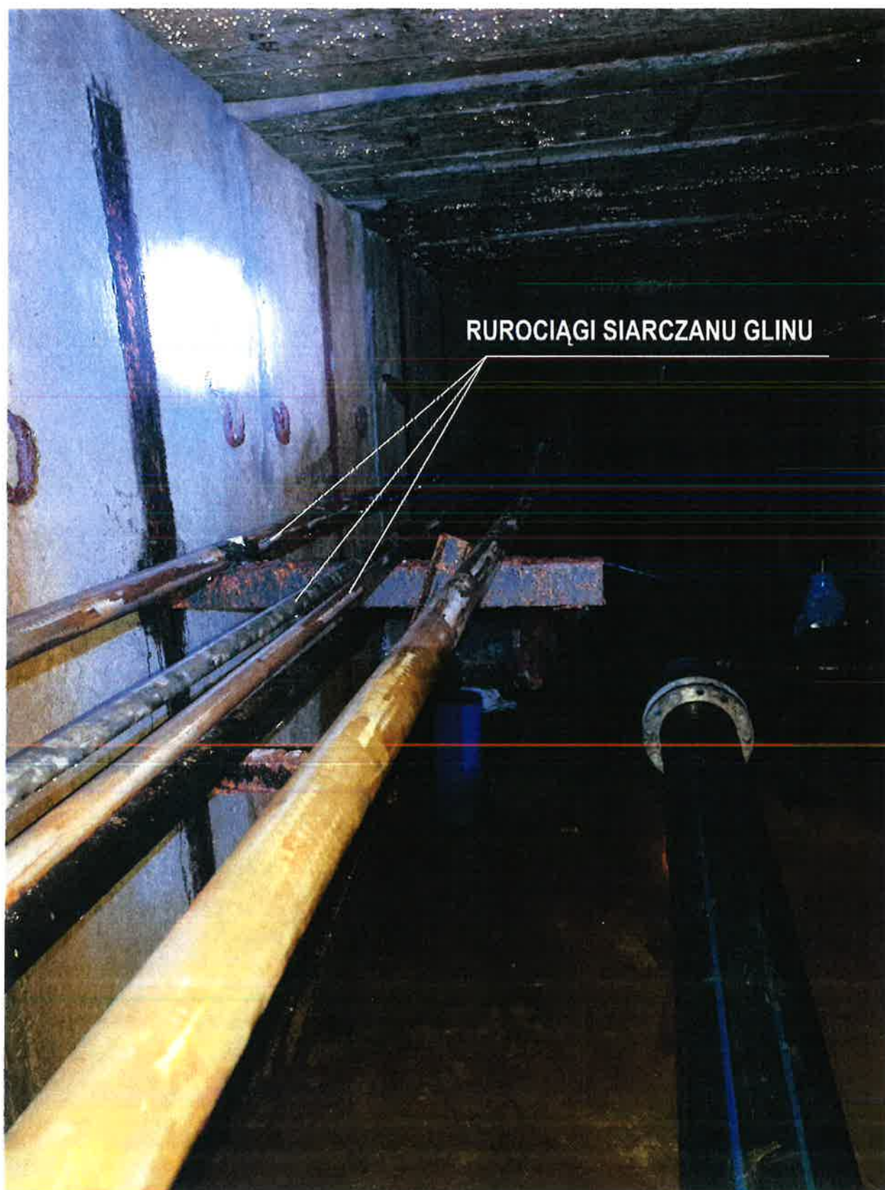
Istniejące rurociągi siarczanu glinu w kanale technologicznym
