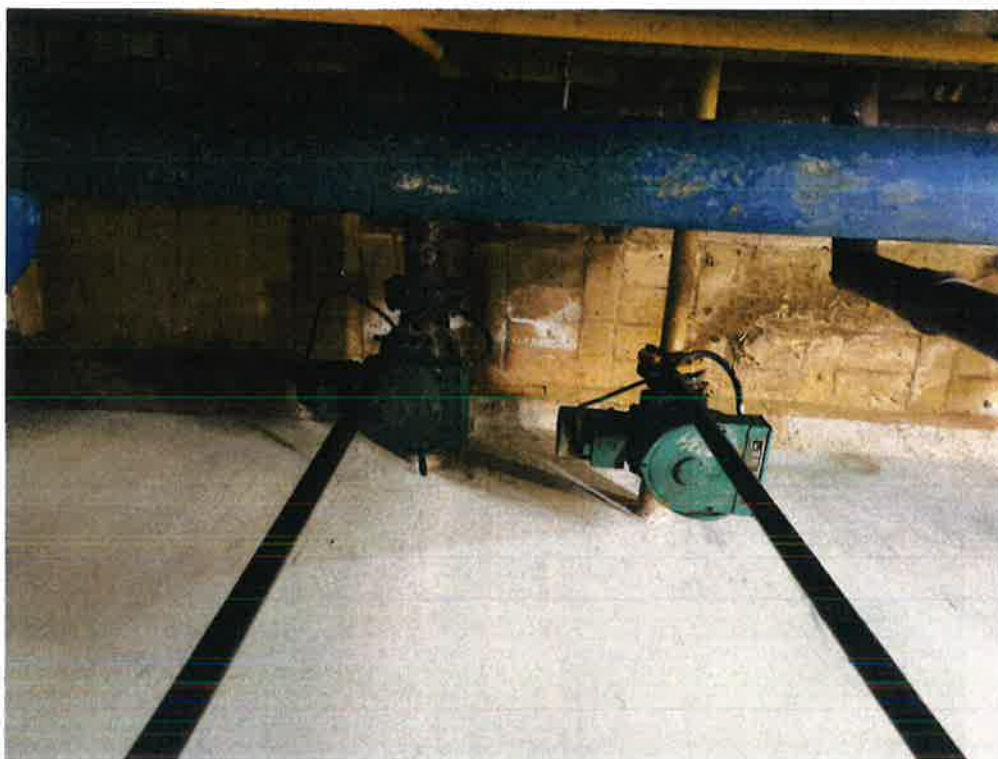
Widok przepustnic z napędami on/off na wyjściu ze zbiorników zarobowych
