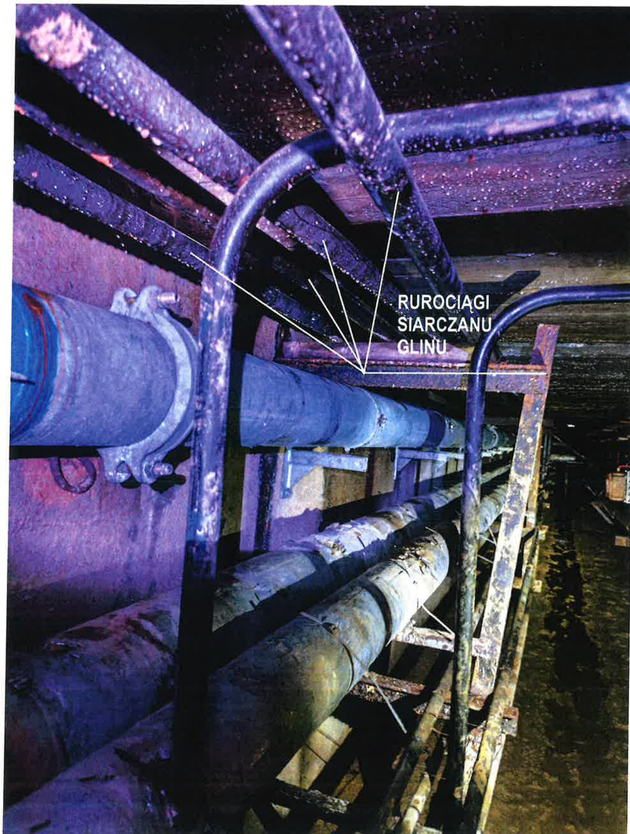
Istniejące rurociągi siarczanu glinu w kanale technologicznym
