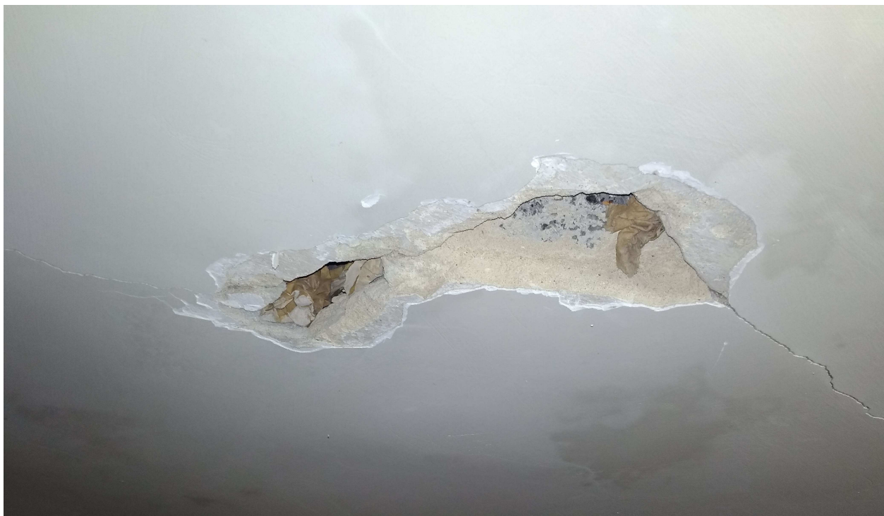
Fot. 1. Widok fragmentu stropu z powstałym ubytkiem tynku i rysą nr 1. Miejsce odkrywki. Widoczne uzupełnienie workami papierowymi ubytków stropu.
