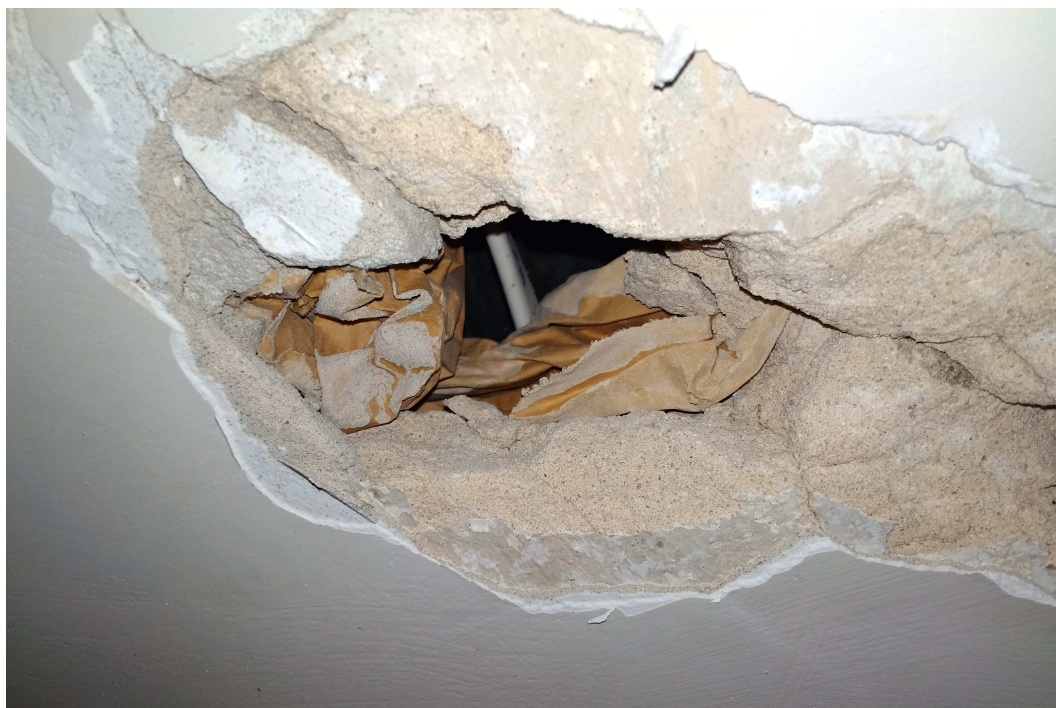
Fot. 2. Odkrywka stropu w miejscu z fotografii nr 1. Widoczny kabel elektryczny wprowadzony do pustaka oraz worki papierowe uzupełniające ubytek dolnej powierzchni pustaka.
