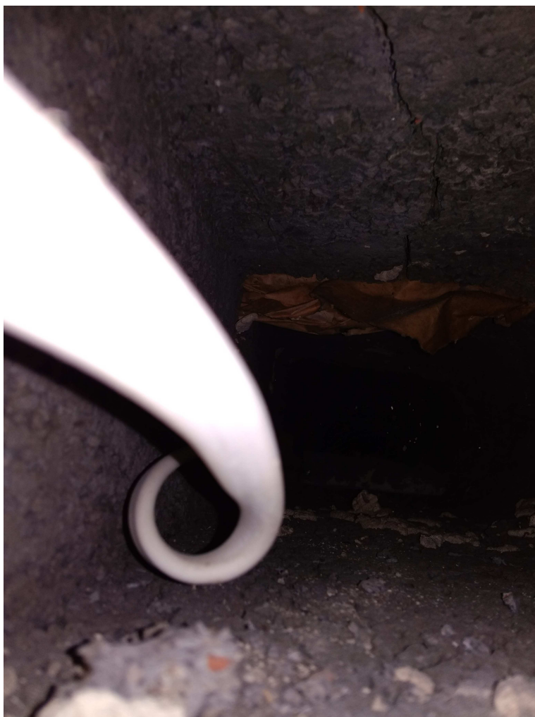
Fot. 5. Widok wnętrza pustaka. Widoczne pęknięcie sklepienia pustaka i przewód elektryczny oraz worek papierowy „uszczelniający” ubytek.
