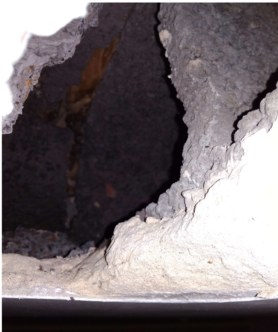
Fot. 4. Miejsce odkrywki. Widoczne uszkodzenie pustaka – ubytek środka i dolnej powierzchni pustaka.
